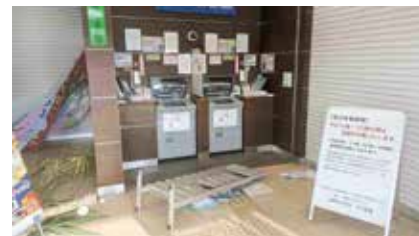
地震発生直後の八代支店の様子
